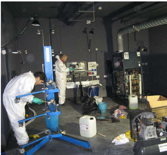
Risanamento elettronico di alcune apparecchiature danneggiate da fulmine
