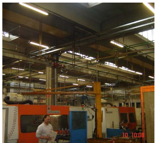
A destra: alcune immagini che evidenziano la contaminazione da fumo e particolato di incendio sulla struttura del fabbricato.
