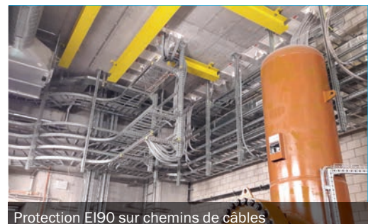
Protection EI90 sur chemins de câbles
