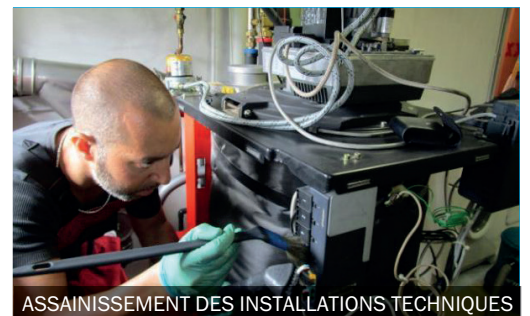
ASSAINISSEMENT DES INSTALLATIONS TECHNIQUES
